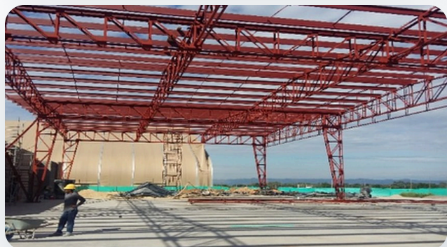
Redes contra incendio en hangares
