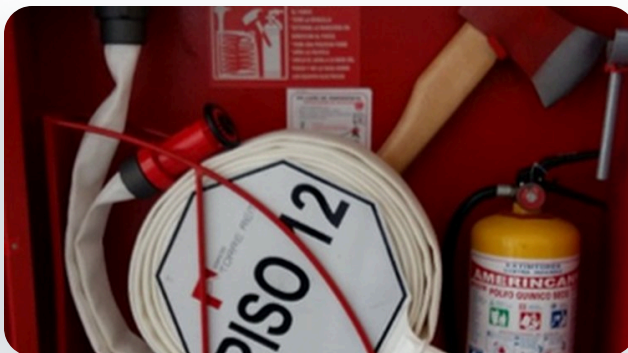
Gabinete contra incendio
