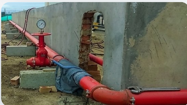
Tubería de la red contra incendio junto a tanque de almacenamiento
