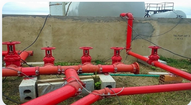
Red contra incendio con tubería y válvulas
