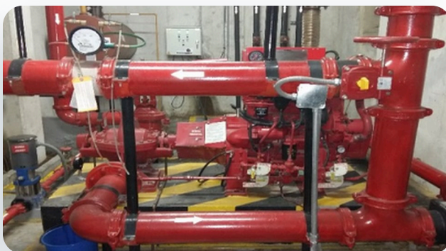
Cuarto de bombas y red contra incendio
