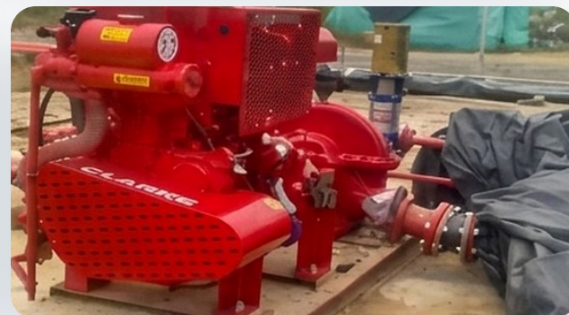
Equipo de bombeo contra incendio
