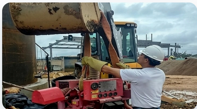
Instalación y mantenimiento de bomba contra incendio
